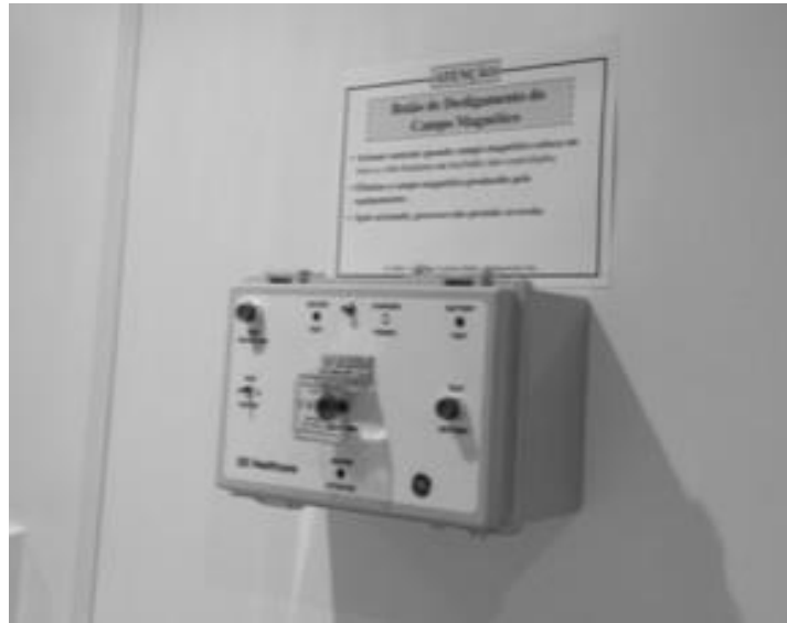
Figura 41: Botão de apagamento do campo magnético (botão de quenching) devidamente sinalizado.
